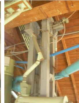
7) Elevator 2 u.3 Antrieb
